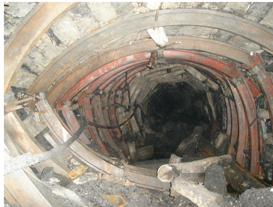
Hình 2. Đường lò dọc vỉa 7 mức + 225 bị nén ép từ các phía
